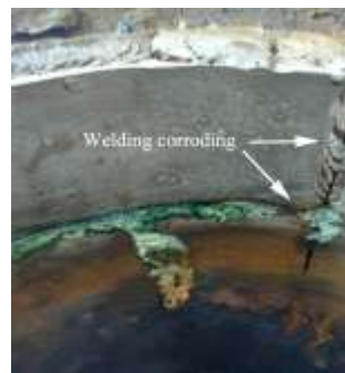
图 1 反应器的腐蚀情况
